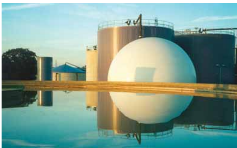
NAGYIPARI BIOGÁZ TELEP DÁNIÁBAN / INDUSTRIAL BIOGAS PLANT IN DENMARK
